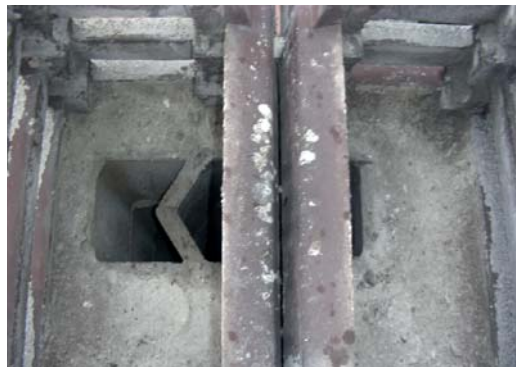
Fig.2.12/b ostruzione da trave
