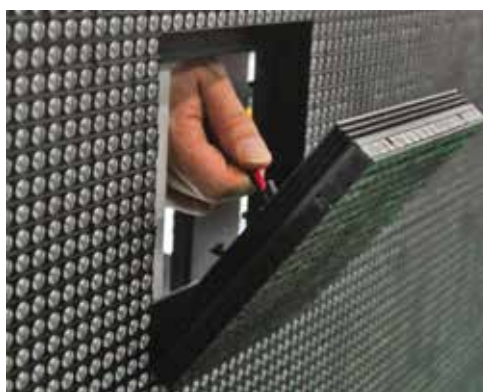
5. Un esempio di cavo di alimentazione erroneamente utilizzato come dispositivo di ritenuta della mattonella sbalzata esternamente
