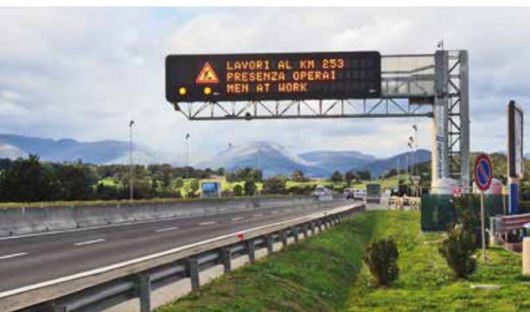
1. Una postazione informativa in autostrada, con l'involucro del PMV alfanumerico e del PMV a doppio pittogramma realizzati da un unico contenitore chiuso, anche sul frontale
